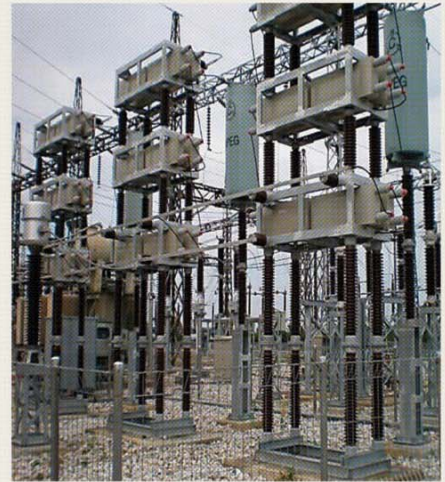
〈Figure 1〉 초고압용 가대형 콘덴서 뱅크
